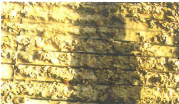
Figura 4.- Armadura transversal existente descubierta en la franja lateral.
